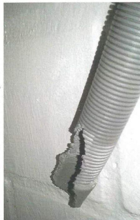
Angefressener Laugenschlauch einer Waschmaschine.
